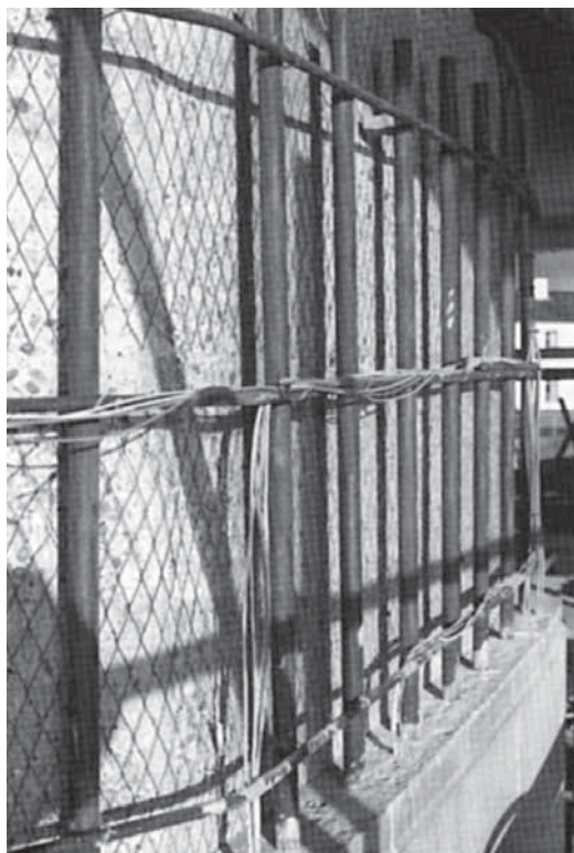
Figura 2.- Malla de Ti-MMO instalada y antes de rellenar con hormigón y cubrirla con mortero.
