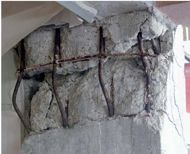
⇒ Figura 8.- Pandeo de las armaduras longitudinales por inadecuada cantidad de cercos en la proximidad de un nudo viga-pilar.
