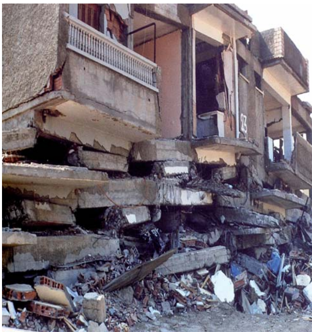
Figura 1.- Fallo frágil de un edificio.
