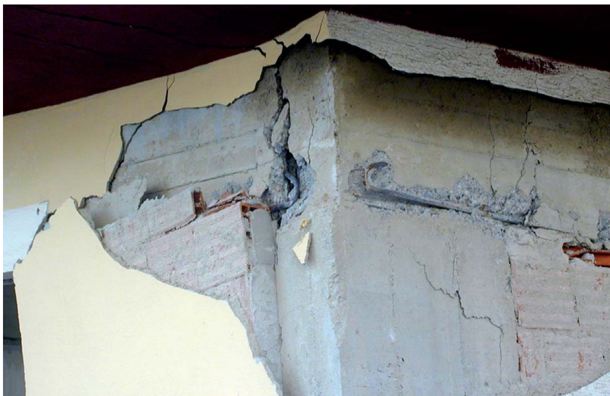
Figura 10.- Extracción de parte del armado de una viga por inadecuados anclaje y recubrimiento.
