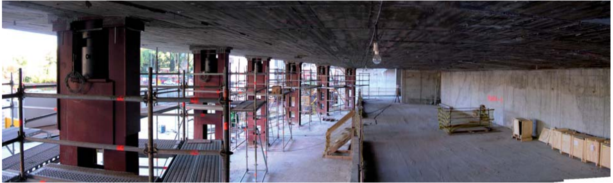
Figura 14 - Teatro Principal. Apeo de la losa en voladizo y sistema de gatos de elevación.
