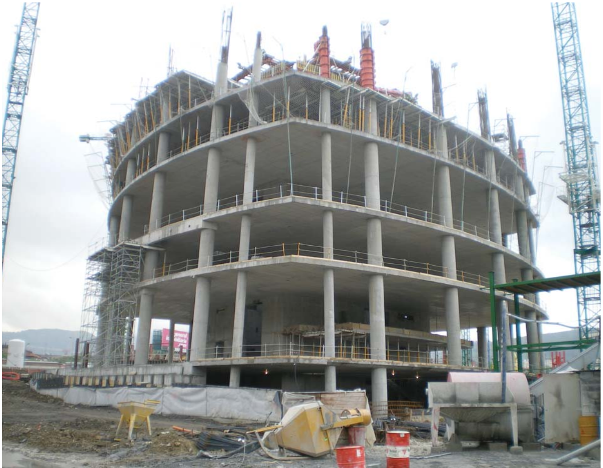
⇒ Figura 13.- Vista general de los forjados desde el pico sur (Fuente: Torre Iberdrola).
