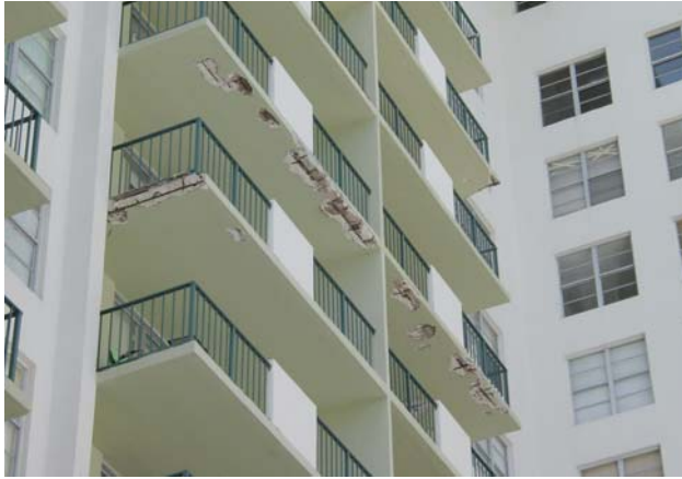
Figura 3.- Detalle de los daños por corrosión que más habitualmente afectan a las edificaciones próximas a la costa.
